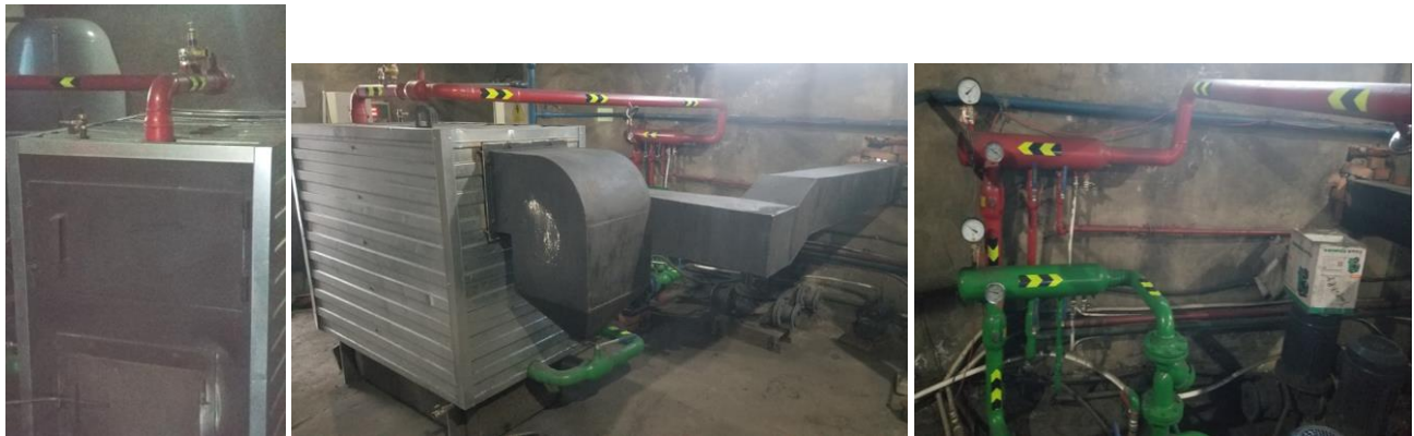
Зураг 1. Шинэ суурилуулсан халаалтын зуух, тэмдэг тэмдэглэгээ
